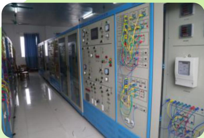
工厂供配电实训室
